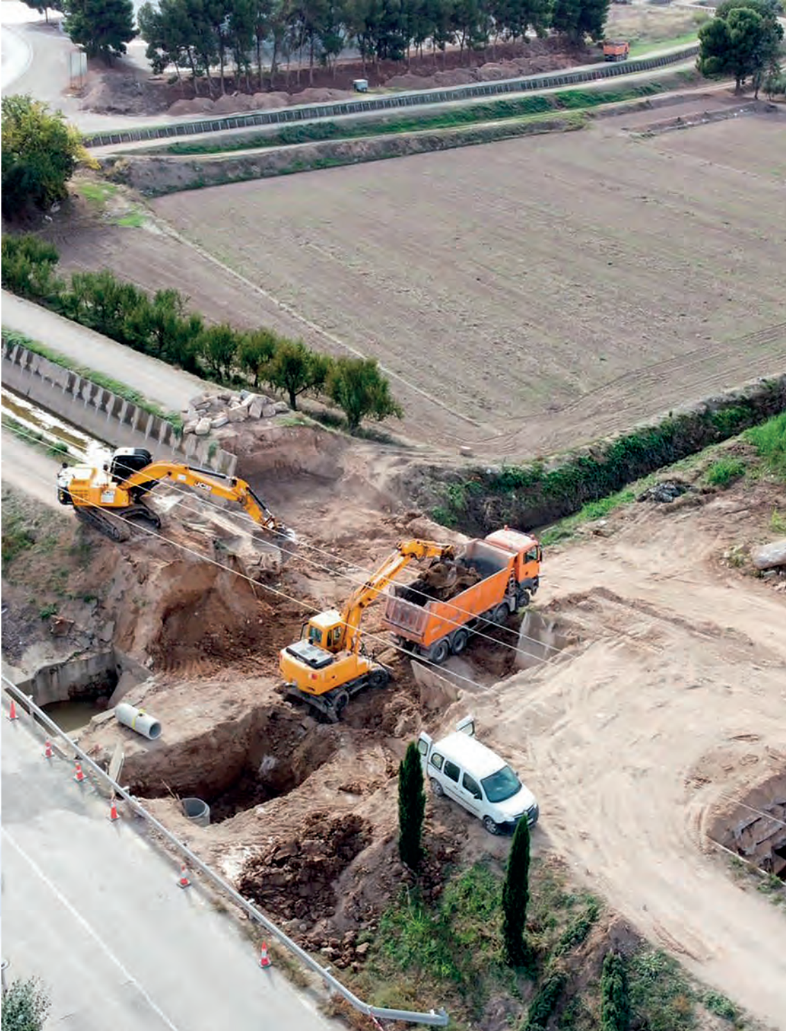
Obres encreuament riu Canals amb el Canal Principal, al PK 103+150, terme d'Arbeca.
